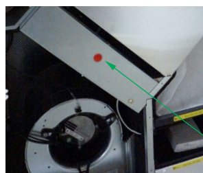
Eftervärmebatteri efter värmeväxlaren
